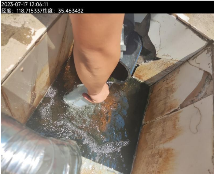
图 1: 污水现场照片
