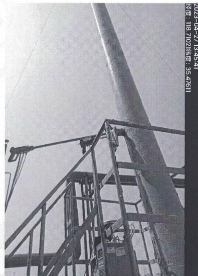
2023.04.27 精制车间废气排气筒出口采样图
